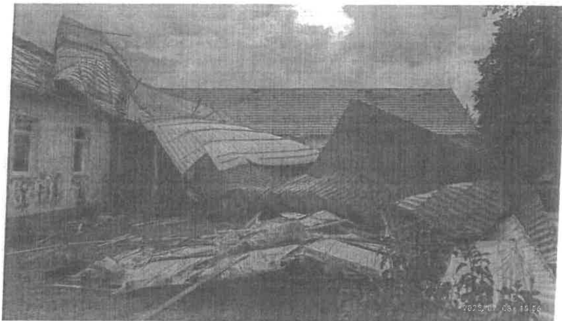
4. sz. kép Viharkár Penészleken az általános iskola tetőszerkezete 2025.07.08.
